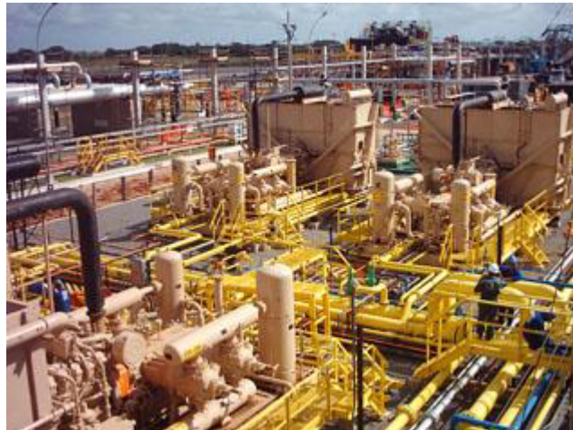
Figura 12 – Estação de Compressão de Gás Natural
